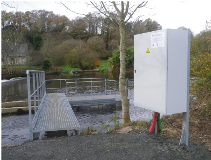
Photo n°6 : Vue globale du système de comptage après installation
