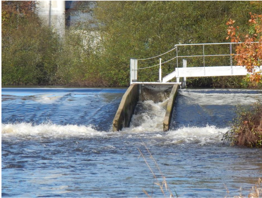
Photo n°7 : Vue aval du système de comptage après installation
